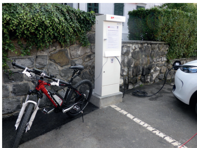
Borne de charge pour véhicules électriques, EBS Schwyz
